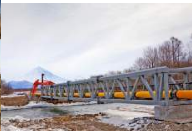
Рис.35. Трубопровод на эстакаде
