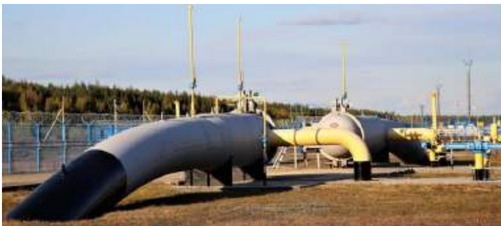
Рис.36. Узел пуска и приема станции очистки (диагностики) (УППСОД)
