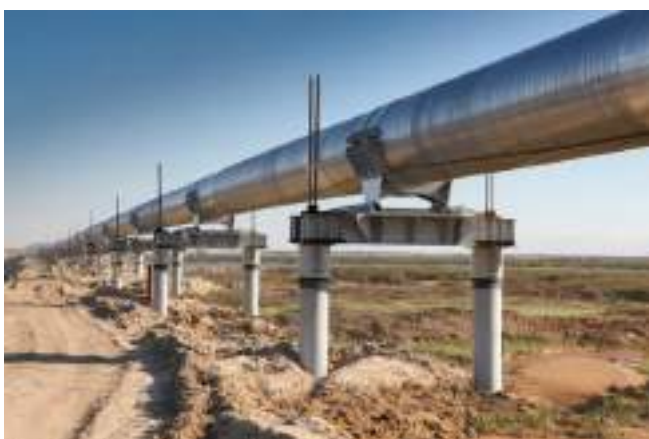
Рис.34. Трубопровод на опорах
